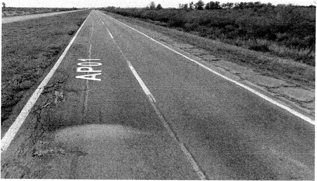
Figura 2 - Fotografía del estado actual entre pk110 y pk135, calzada ascendente.
